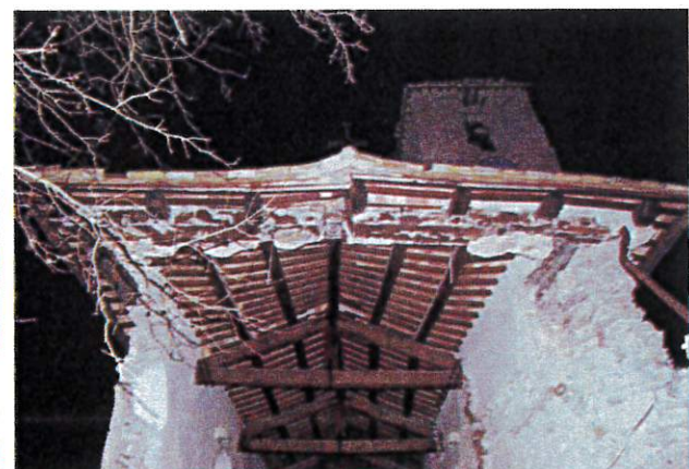
Figura 22 Chiesa di Norcia. Comportamento divaricante assunto dal cordolo sul timpano nel corso del crollo della facciata.
