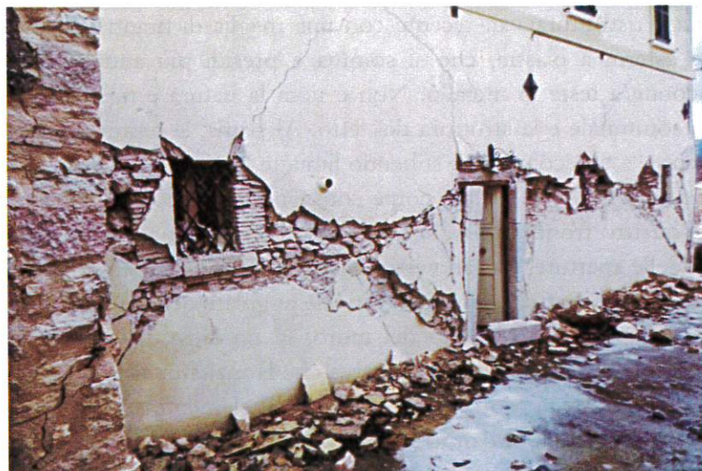
Figure 1-2-3 Lesioni a taglio al piano terra sui muri perimetrali di edificio ad Avendita di Cascia (PG)
